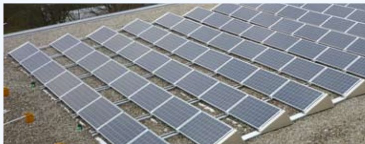
Seit Kurzem produziert eine Photovoltaikanlage auf dem Münchner Zahnärzthaus umweltfreundlichen Strom.
